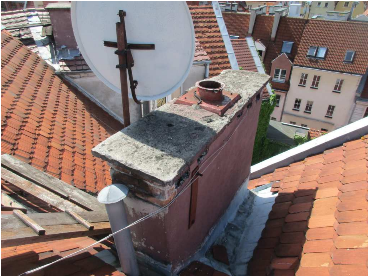
Fot. 3. Tynki kominowe odspojone, czapy betonowe lokalnie spękałe i na krawędziach odspojone
