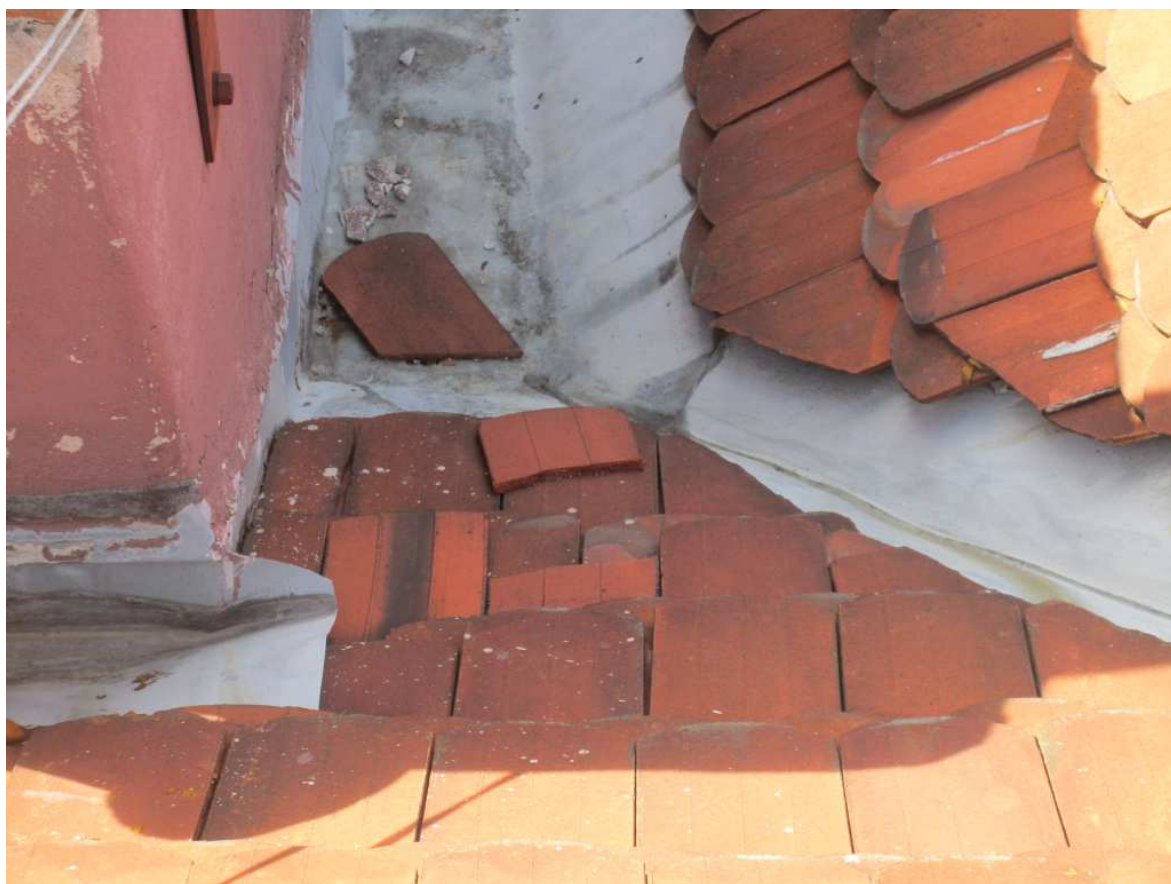
Fot. 2. Dachówka miejscami spękana
