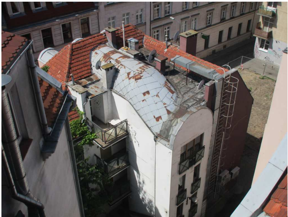
Fot. 6. Pokrycie z blachy ocynkowanej skorodowane
