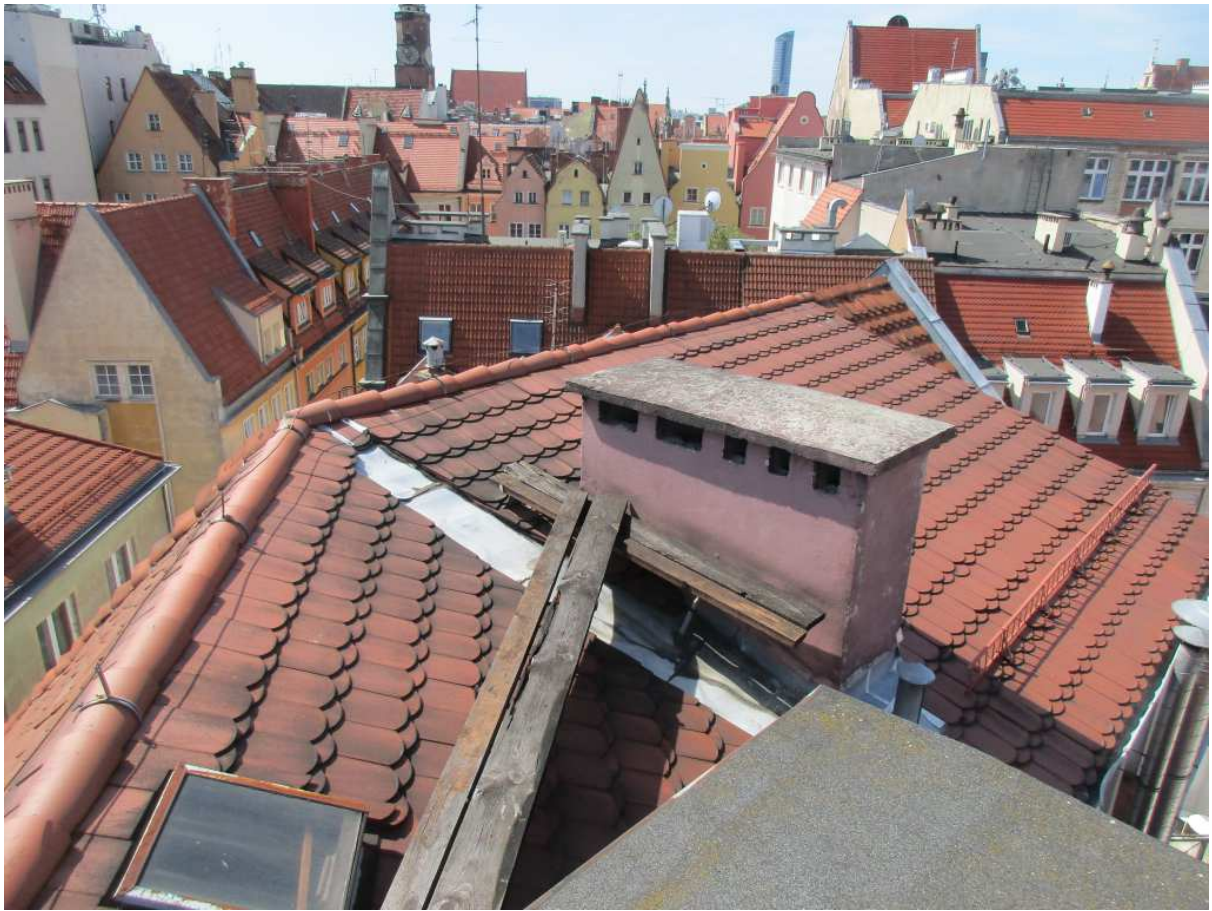
Fot. 5. Drewniane ławy kominiarskie zmurzone
