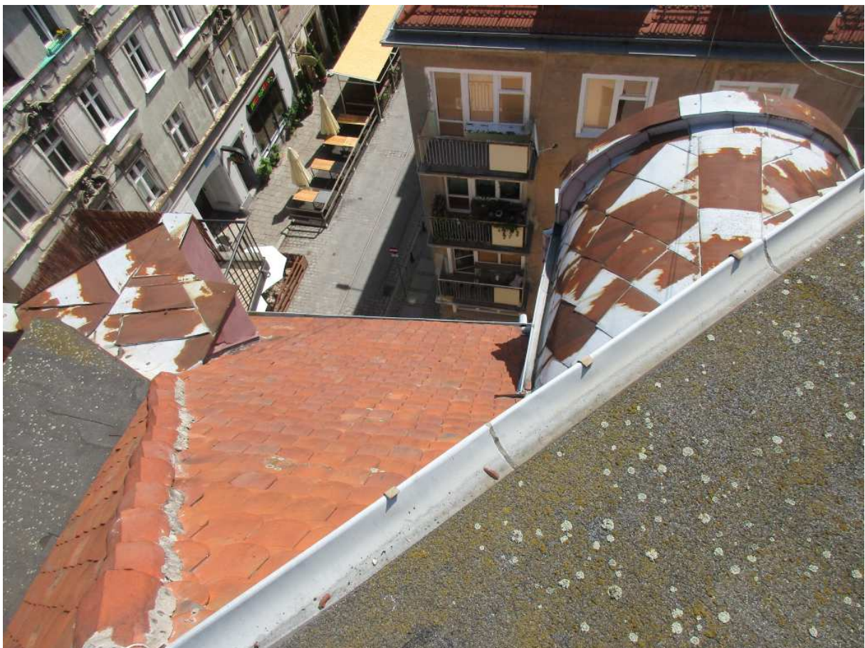
Fot. 4. Pokrycie lukarn skorodowane
